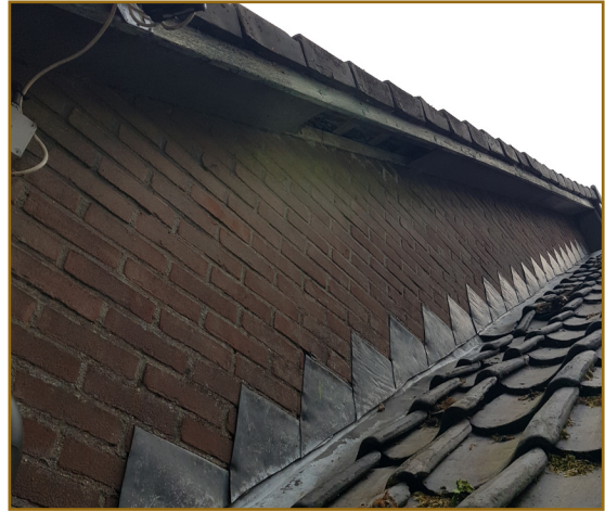
Afb. 2.8: Foto van de kopse kant van het dak aan de zuidkant van schuur 2 waarbij er te weinig ruimte is voor een uitvliegroue van vlemuizen.
